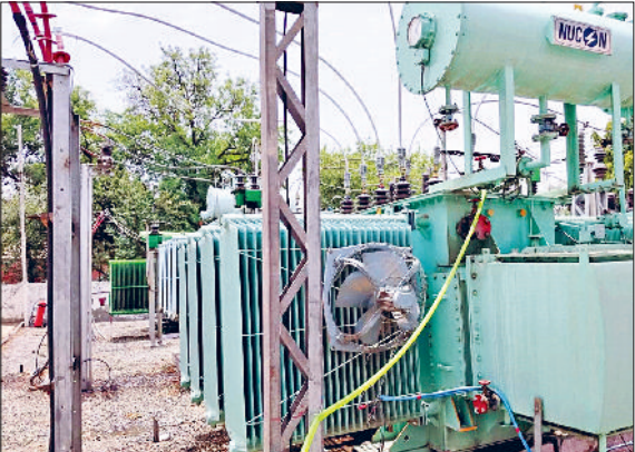
फतेहाबाद। 133 केवी बिजली घर में लगा बड़ा ट्रांसफार्मर।
